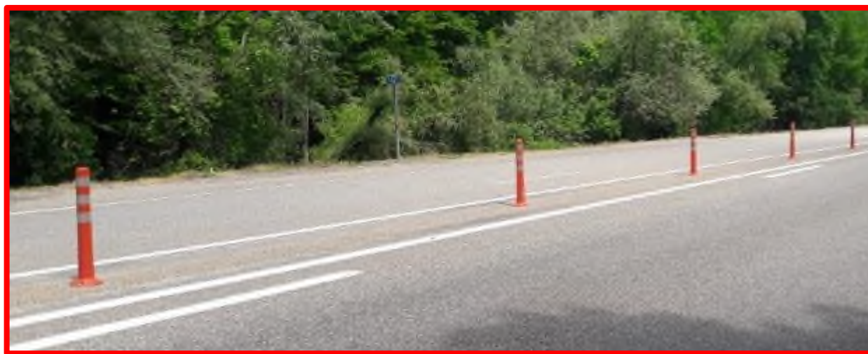
Загрязнение наносным грунтом разделительной полосы
