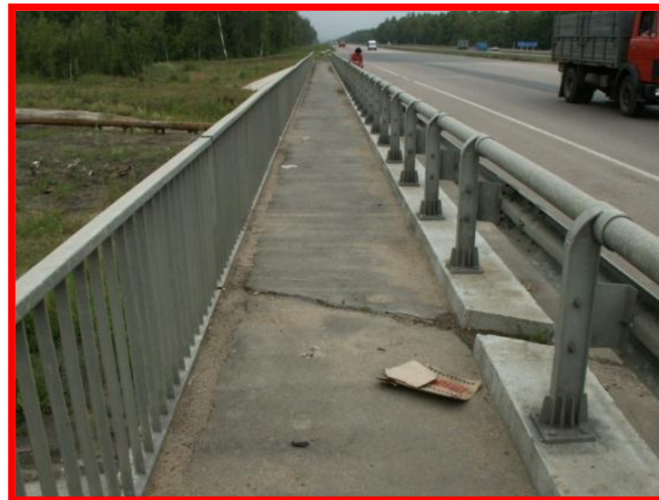
Не очищенные от мусора тротуары мостовых сооружений
