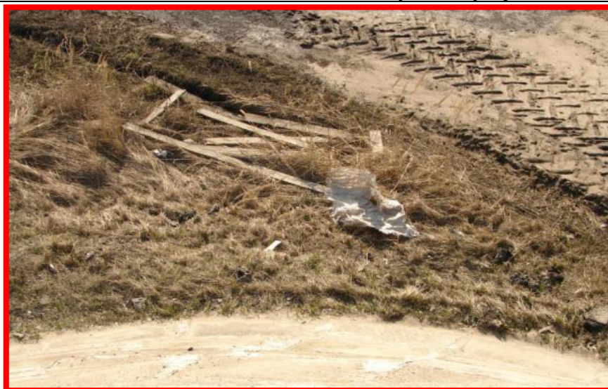
Не очищена подмостовая зона от посторонних предметов
