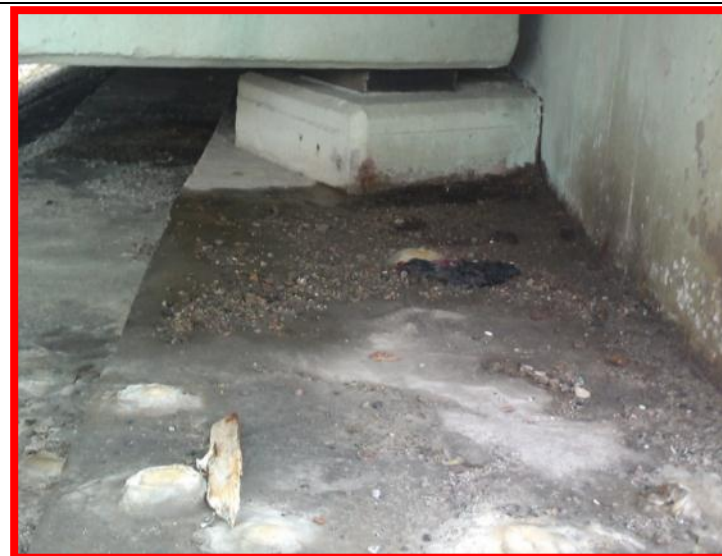
Не очищена верхняя площадка опор от мусора
